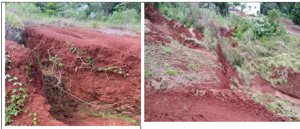
FIGURA 12 –Figura mostrando erosões formadas na Reserva Municipal 17, da quadra 1541.
