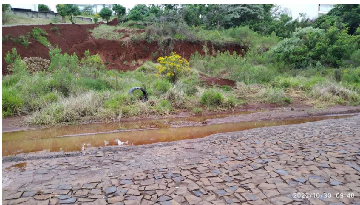
FIGURA 05 – Fotografia mostrando, na quadra 1541, na Rua das Oliveiras, água pluvial parada por falta de sistema de drenagem.
