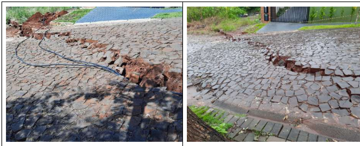
FIGURA 07 – Fotografia mostrando fissuras de rastejos ao longo da Rua das Oliveiras, na quadra 1541, que surgiram após evento de grande pluviosidade no mês de outubro de 2022.
