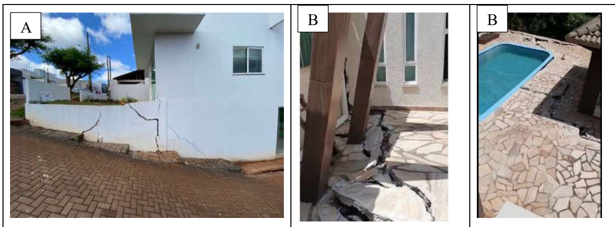
FIGURA 08 – Fotografia mostrando rachaduras na casa do lote 6 (A), e na casa do lote 5 (B).
