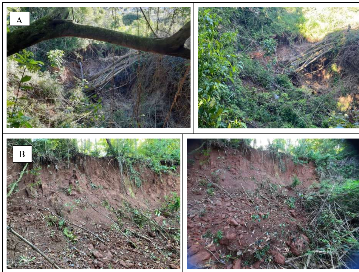
FIGURA 14 –Figura mostrando cratera formada pela água da chuva (A) e taludes escavados pela erosão da água, retirando o apoio da encosta a montante (B).
