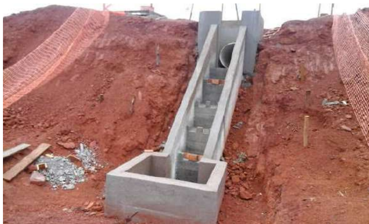
FIGURA 11 –Figura mostrando exemplo de dissipador de energia que evita a formação de processos erosivos.
