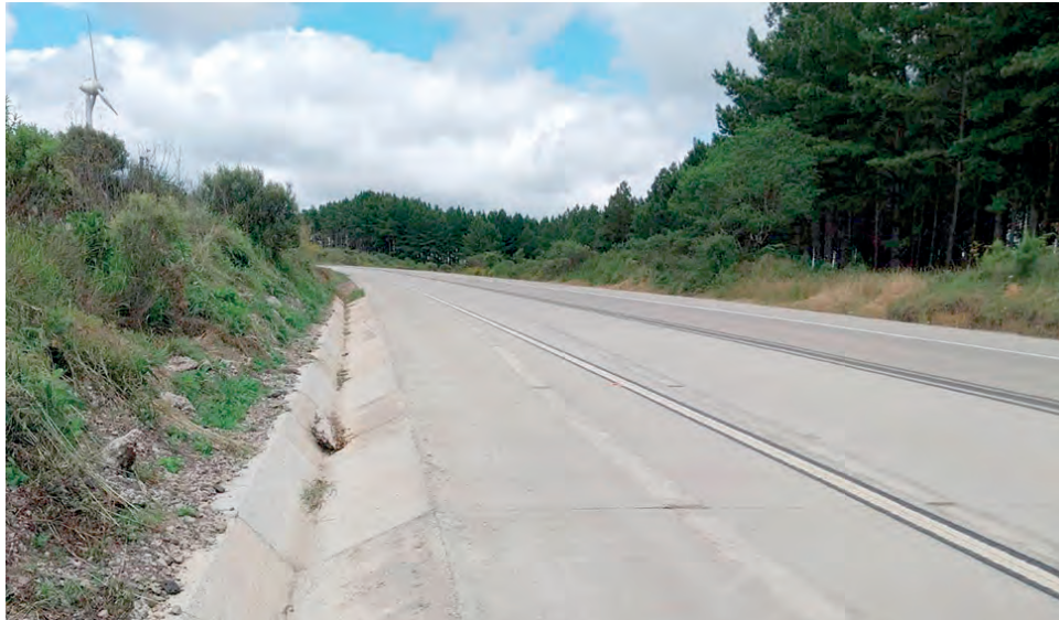
Os 59 quilômetros, da PR-280, entre Palmas e o trevo do Horizonte já foram concretados
